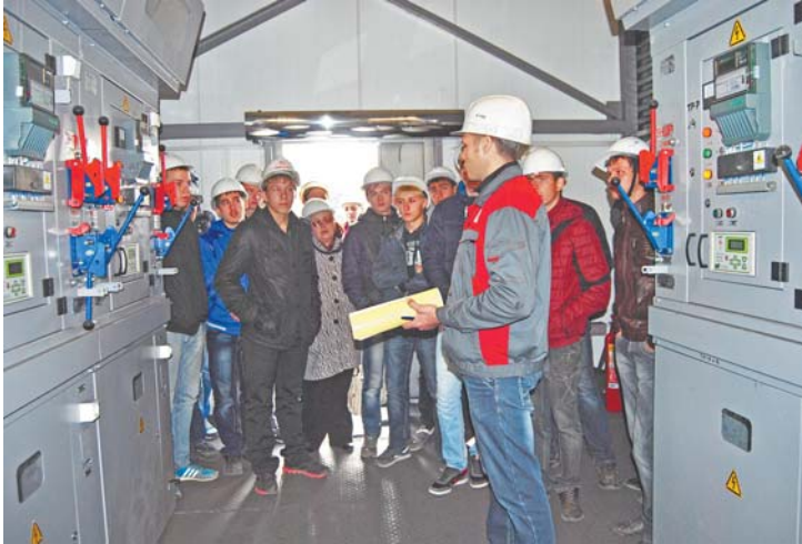
Роман Зенин, энергетик «Сибирского Антрацита», рассказал студентам филиала Новосибирского монтажного техникума о работе электрооборудования и распределении электроэнергии на предприятии.
